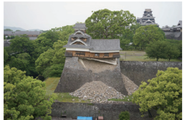
図-33 石垣崩壊の様子
